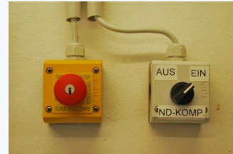
Notaus für Kompressor & Booster
